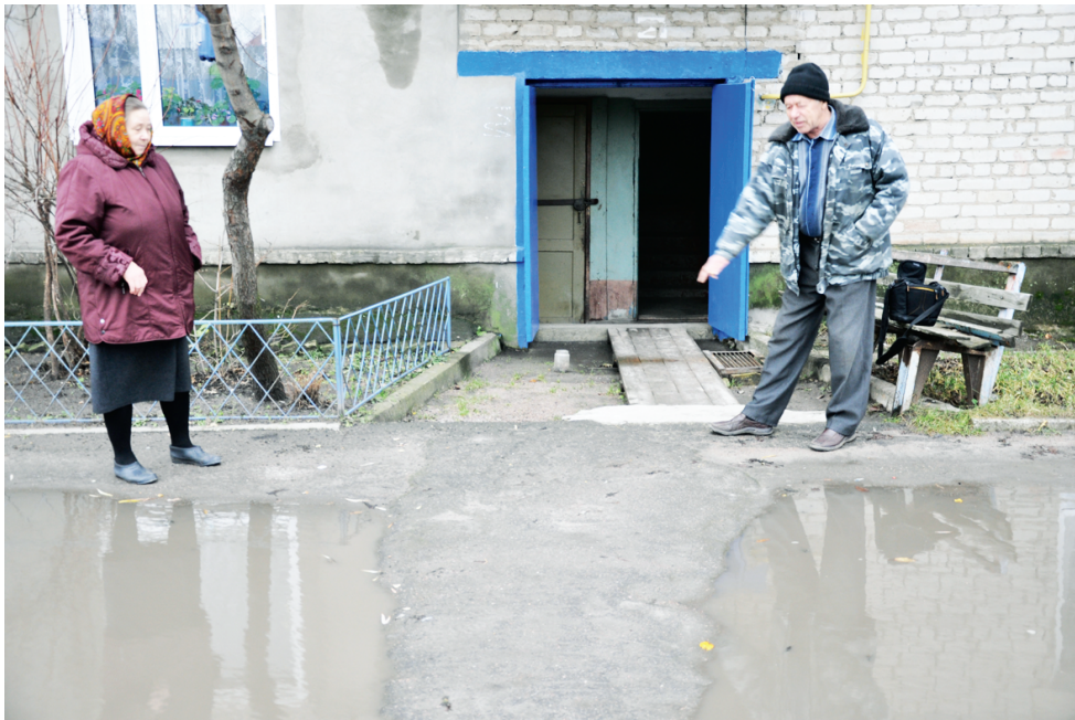
Жильцы дома №14 по ул.Гагарина Мария и Алексей Самсоновы: «В результате заниженного уровня первого этажа вся вода с дворового проезда оказывается в подъезде».
